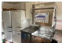
Küche: Kühlschränke, Geschirrwassmaschine
